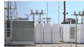
ESS電流遮断
