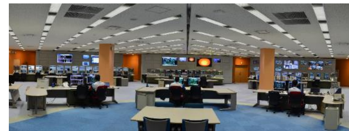
統合生産センター
