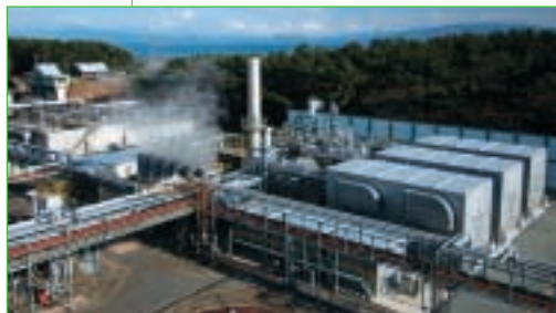
ポリプラスチック富士工場の天然ガス・コジェネレーション設備
