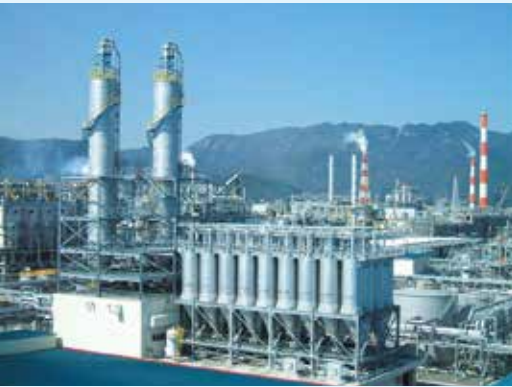
三酢酸セルロース(TAC)製造設備
