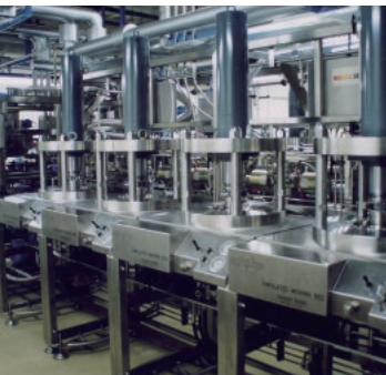
キラル分離精製設備
